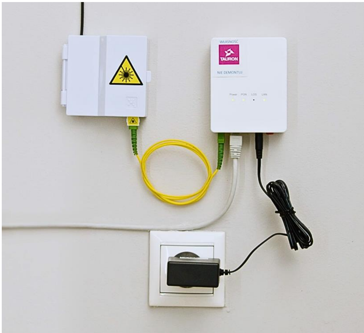
Urządzenie ONT zainstalowane w Państwa domu
